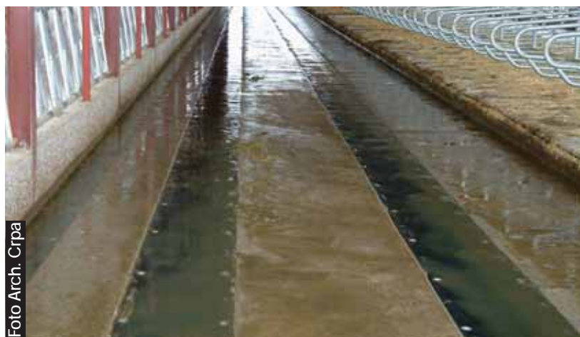
Foto 1 - Zona di alimentazione con 3 strisce di gomma longitudinali per tutta la lunghezza della corsia poste all'interno di cunette predisposte nel pavimento.
