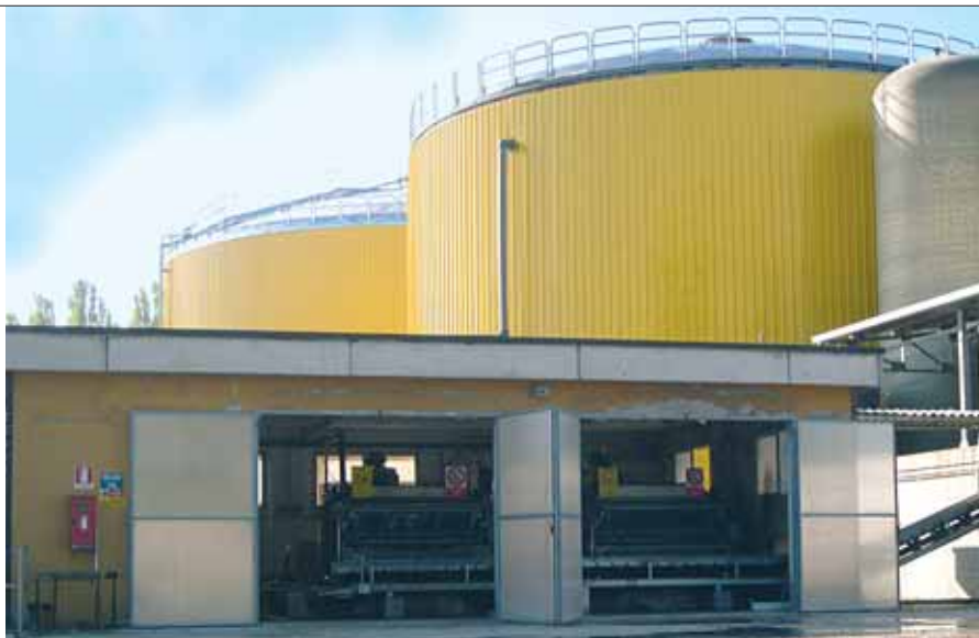
Impianto di biogas centralizzato di Spilamberto (MO), con codigestione di liquami suinicoli, scarti agroindustriali e sottoprodotti animali; in primo piano i due digestori da 8.000 e 4.000 m 3 e le nastropresse per la disidratazione del digestato. (Foto Arch. Crpa)
