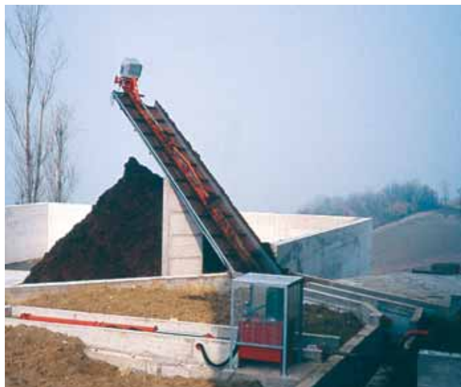
Concimaia a platea con elevatore fisso.
